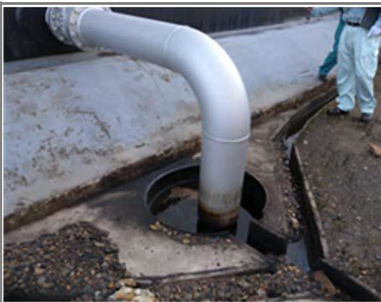
スロッシングにより浮き屋根上に溢出し た油がルーフトレン配管から流出 (出典：消防研究センター)
