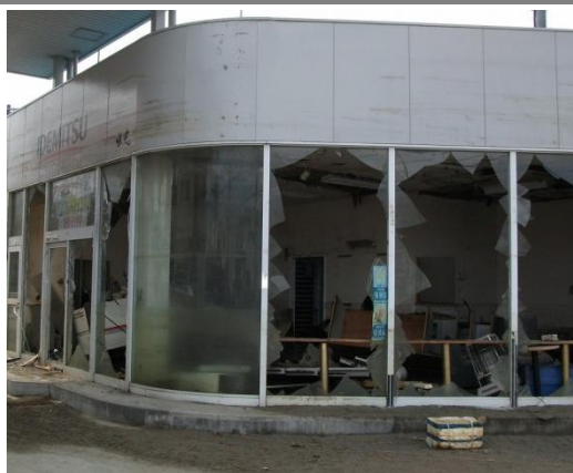
津波により破損した建築物（サービスルーム） (出典:全国危険物安全協会)
