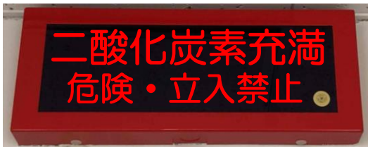
ガス消火剤放出表示灯
