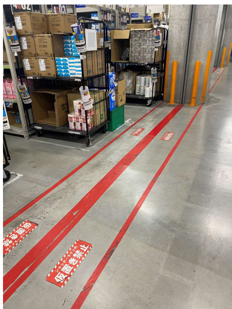
実例(4)カ：防火シャッターの降下空間に物品を置いてはいけないことをテープにより明示
