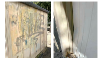
「落書き」と「破損」の様子
