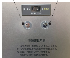
消防運転方法銘板
