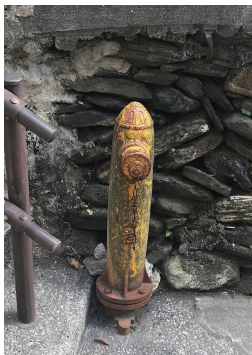
消火栓（地上式）
