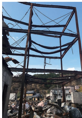
火災により溶融した鉄筋
