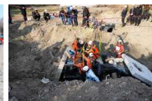
道路崩落現場での活動
