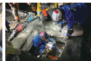
倒壊建物での活動
