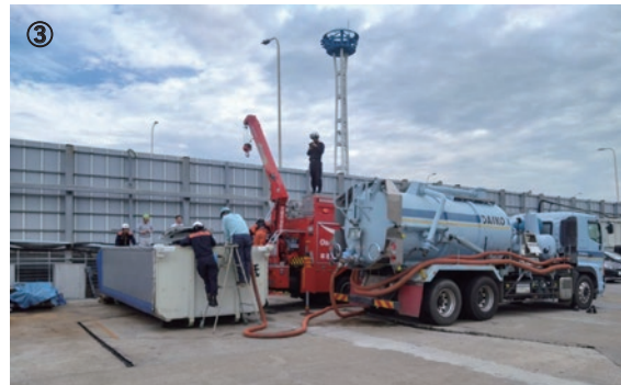
写真1 リチウムイオンバッテリー火災現場
