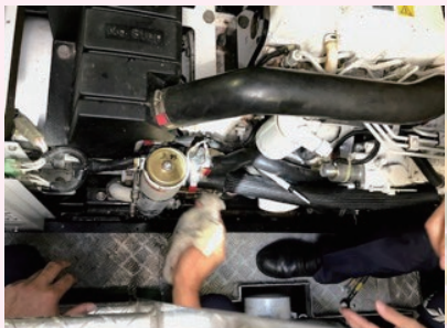
消防艇『ゆうなぎ』の機関場
