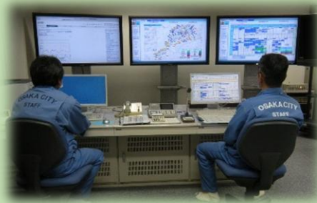
防潮扉と水門の集中監視
