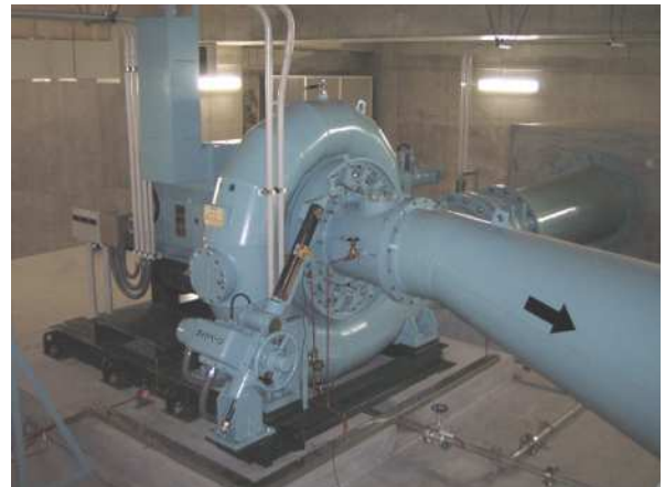
【水力発電設備】
