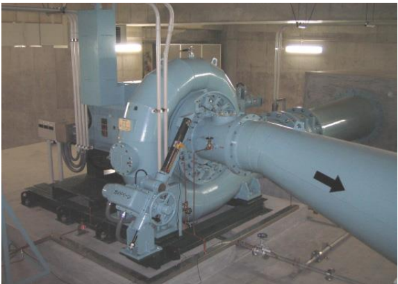
小水力発電設備（長居配水場）
