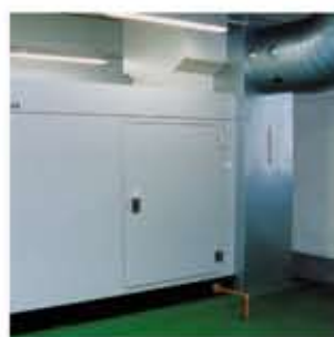
住吉配水場 (施設運転用自家発電設備)
