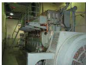
施設運用自家発電設備(箕配水場)
