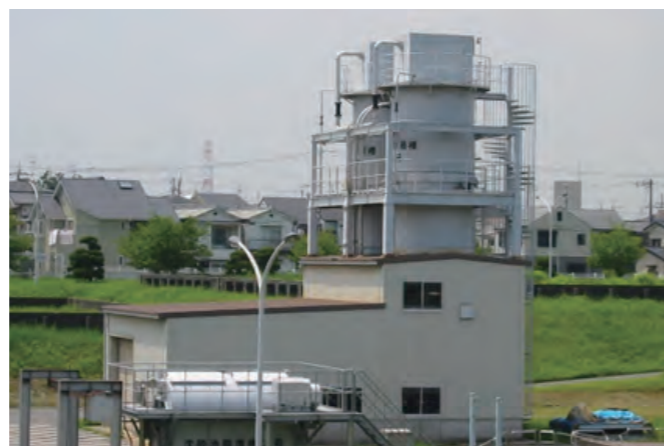
■ 図 粉末活性炭注入設備(楠葉取水場)
