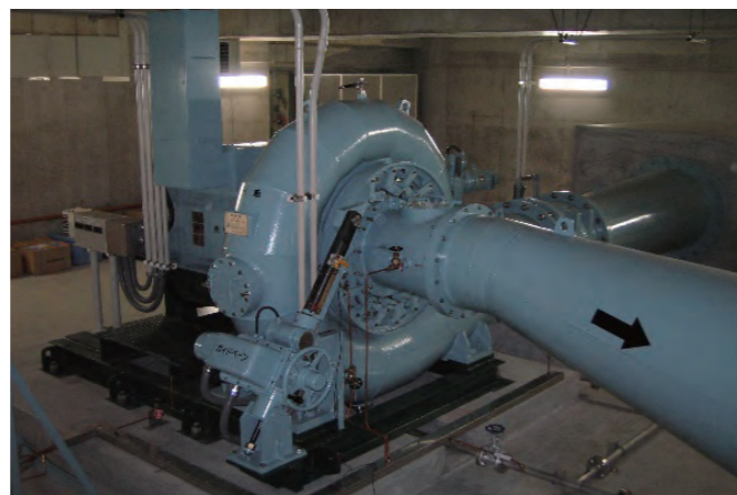
■ 図 水力発電設備(長居配水場)
