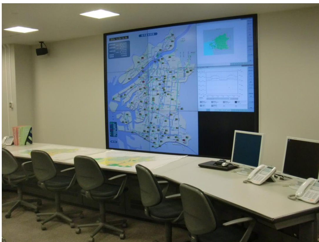
配水情報センター（水道局庁舎内）
