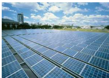
柴島浄水場太陽光発電設備
