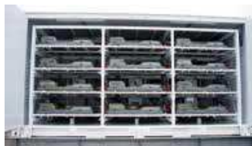
複数のEVリユース蓄電池を活用した電力貯蔵システムの構築例
