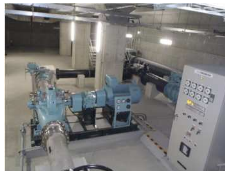
水力発電設備の設置例 （泉尾配水場）
