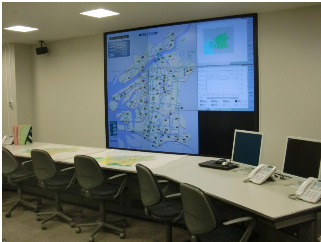
配水情報センター（水道局庁舎内）
