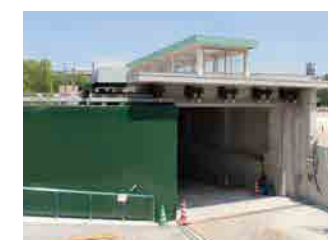
泉尾配水場の防水扉(開放時)
