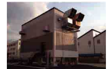
大淀配水場の自家発電設備
