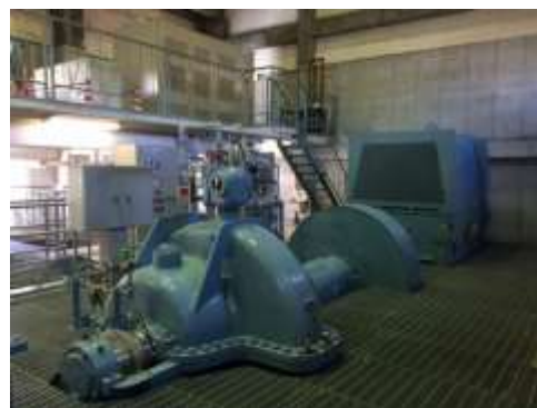
〈楠葉取水場 ポンプ設備〉
