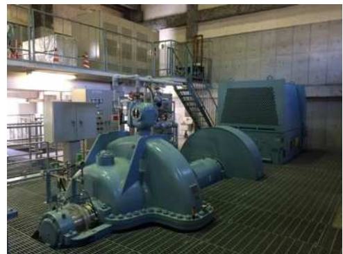
〈楠葉取水場 ポンプ設備〉
