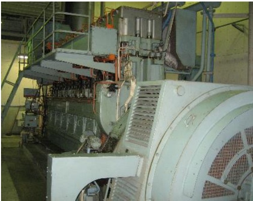
施設運転用自家発電設備 （巽配水場）
