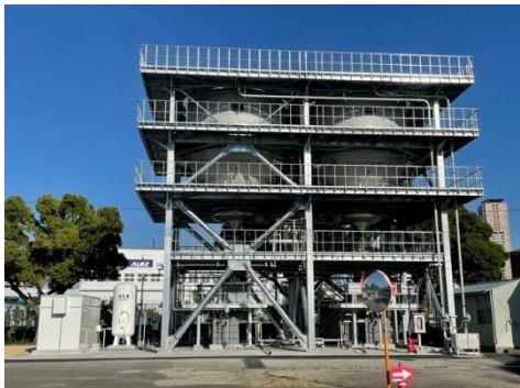
粉末活性炭注入設備 （庭窪浄水場）
