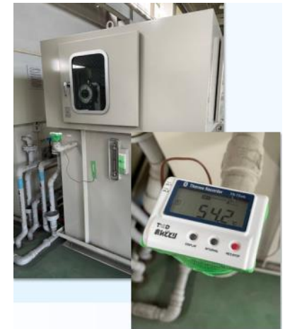
配水ポンプに設置した温度センサ
