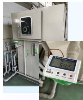
配水ポンプに設置した温度センサ
