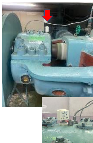
配水ポンプに設置した振動センサ
