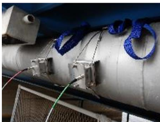
〈超音波流量計の設置状況〉
