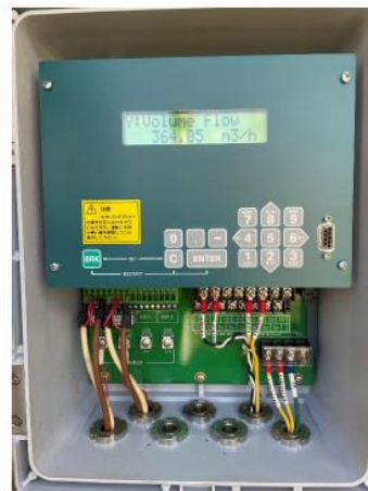
桜宮配水場流量計変換器（更新後）
