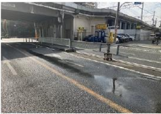
吉野4丁目：漏水状況
