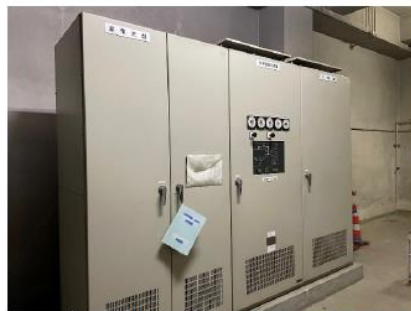
鶴見配水場無停電電源装置（既設）
