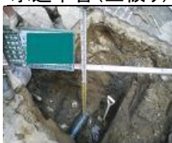
水道本管(土被り)
