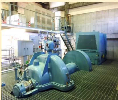
ポンプ設備の省エネルギー対策
