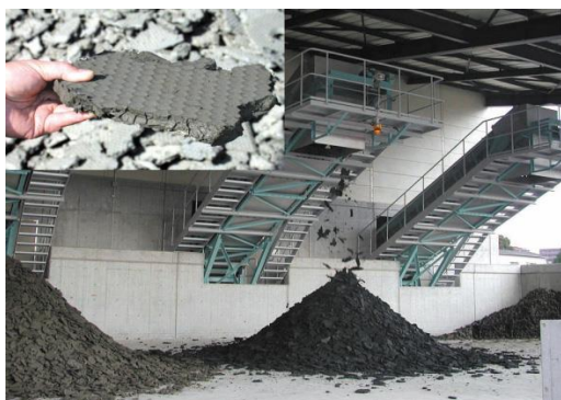
【排水処理施設】
