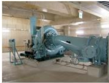
水力発電設備
