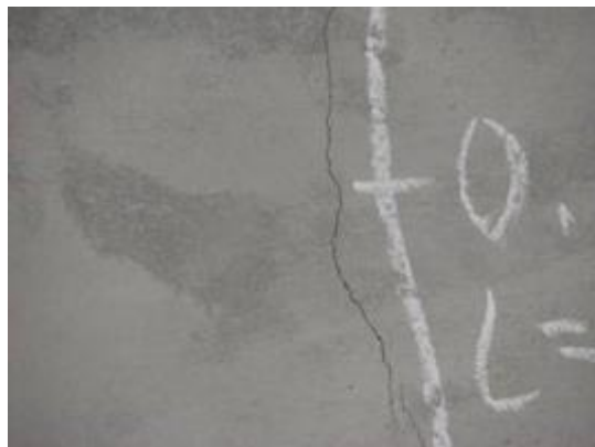
ひび割れ写真
