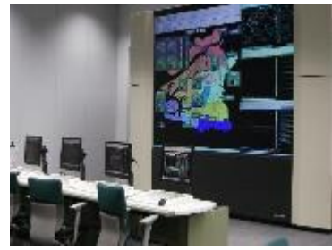
監視制御設備
