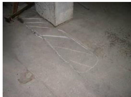
浮き・剝離写真
