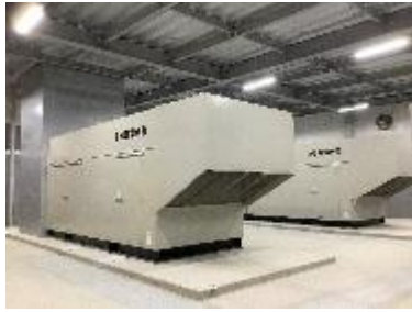
非常用発電設備
