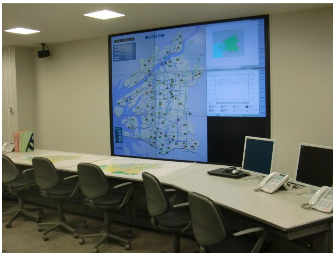
配水情報センター（水道局庁舎内）
