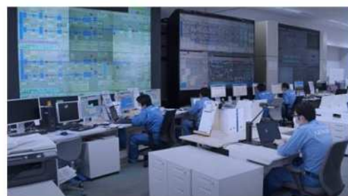
監視制御システム （総合水運用センター内）
