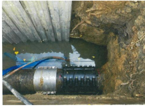
住之江区北加賀屋 5 漏水対応
