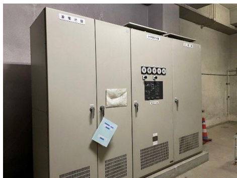
鶴見配水場無停電電源装置（既設）
