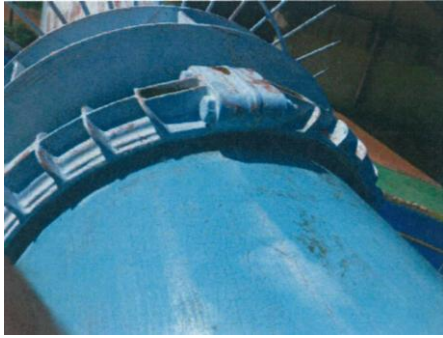
西淀幹線新歌島橋水管橋漏水対応
