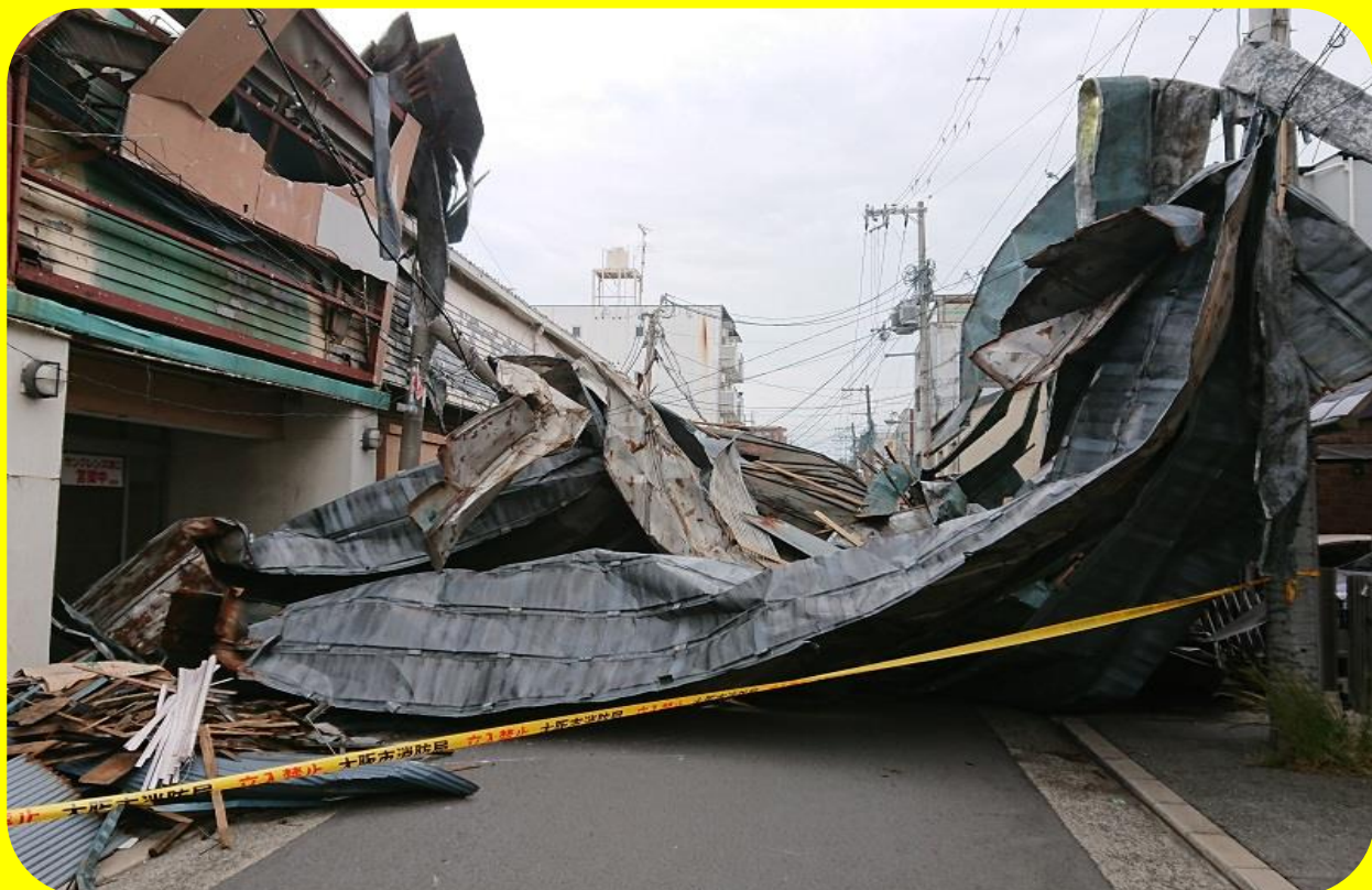
平成30年台風21号で被災した大阪市内の写真
