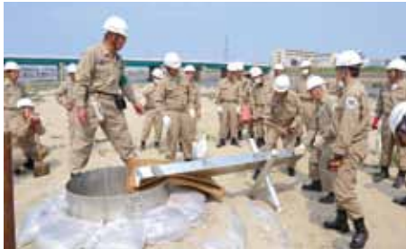
堤防裏側に噴出した漏水の被害拡大を防ぐ簡易釜段工訓練
