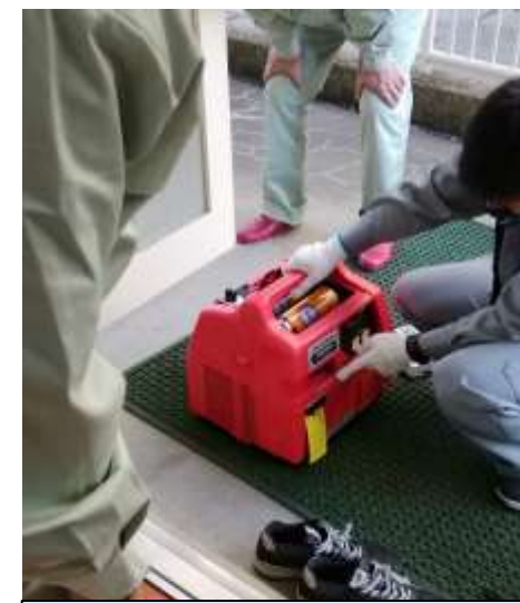
発電機の確認
