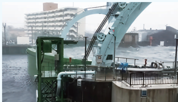
平成30年台風第21号による 高潮に耐える木津川水門
