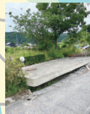
隆起した地下受水槽
