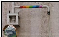
（取水口：千島下水処理場）
