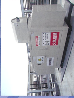
非常用発電設備
