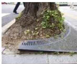
根上がりによる施設損壊
