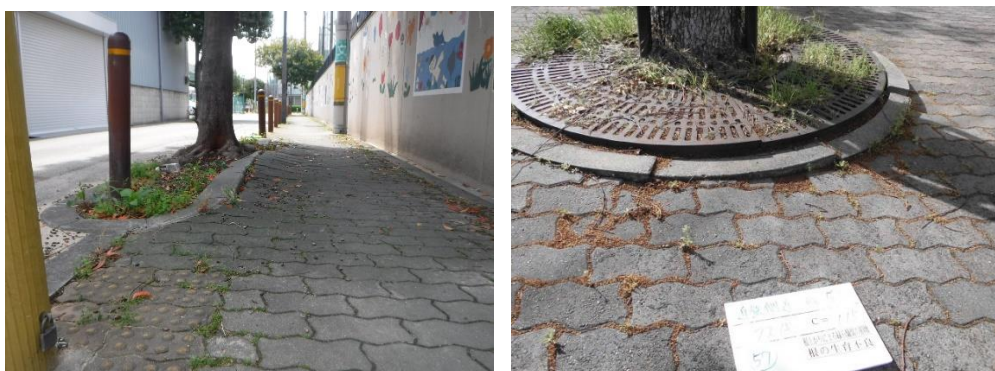
写真 根上りによる舗装の不陸等
