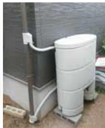
雨水貯留タンク
