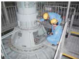
雨水ポンプの診断
