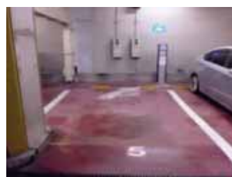
EV 用充電施設（大阪役所）
