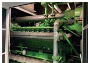
津守下水処理場の消化ガス発電機設備
