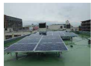
屋上に設置した太陽光発電設備
