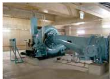
長居配水場の水力発電設備
