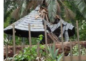
公園施設の被害状況（鶴見区：鶴見緑地）
