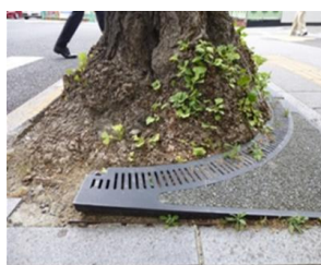
根上がりによる施設損壊
