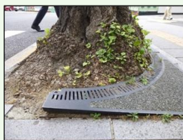
写真 大木化による根上り
