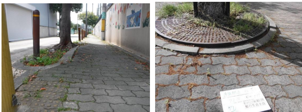
写真 根上りによる舗装の不陸等
