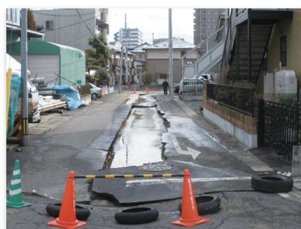
●道路が陥没した様子
