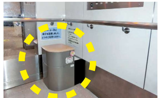
簡易トイレを備えたエレベーター (天王寺区役所)
