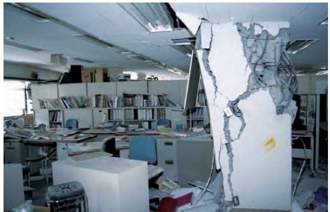
鉄筋の損傷による天井等の破損、崩落
