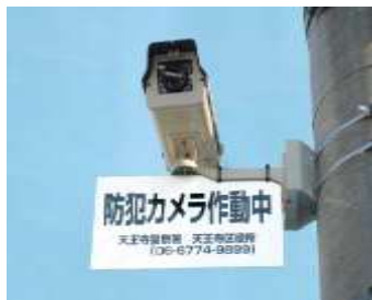
電柱に設置した防犯カメラ
